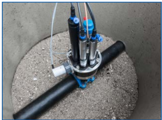
pipe::scan zur Überwachung der Trinkwasserqualität
